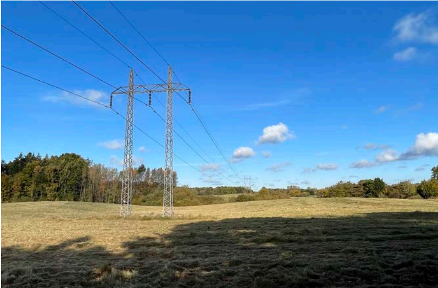
Figur 8-6: Højspændingsledninger i områdets nordlige del
